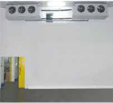
Atmosfer Kontrollü Soğuk Muhafaza Odası
