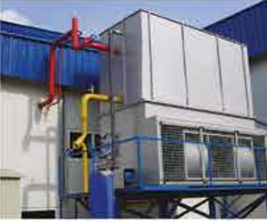
Atmosfer Kontrollü Soğuk Muhafaza Tesisi Evaporatif Kondenseri
