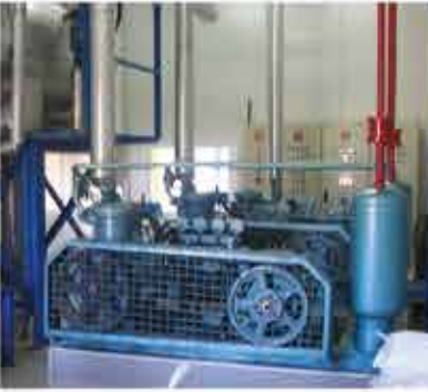
Atmosfer Kontrollü Tesis Amonyaklı Gazlı Soğutma Makine Dairesi
